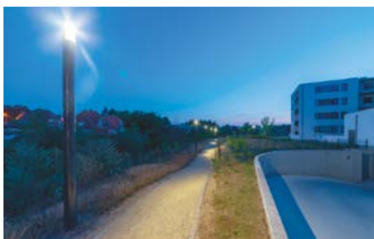
Éclairage LED d'un sentier à Court-Saint-Étienne
